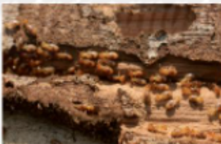
Mối phá hoại công trình xây dựng
