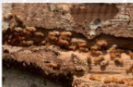
Mối phá hoại công trình xây dựng
